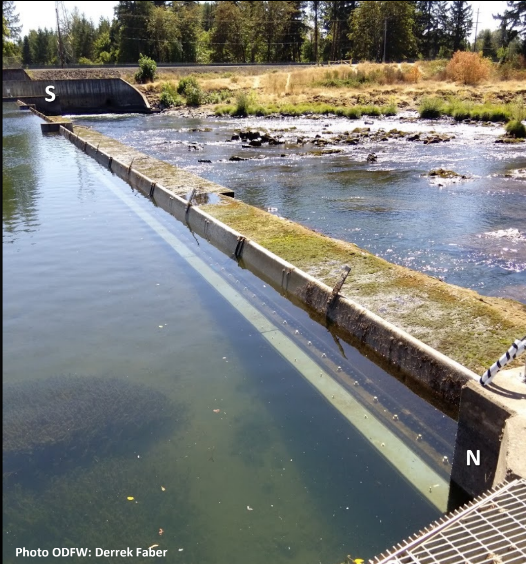
Spanning antenna LD4
